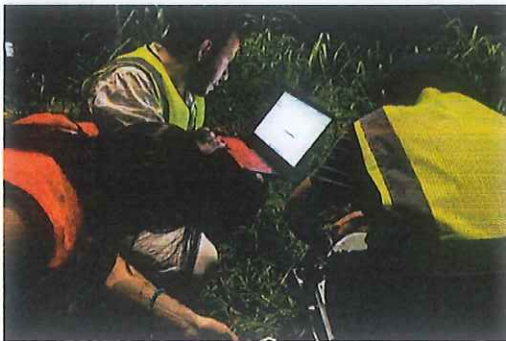
Instalación de contadores automáticos para la recolección de datos.
