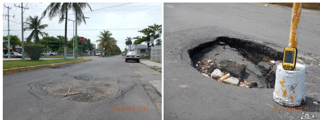
Fotografía 8. Evidencias de hundimientos por colapso en la ciudad de Chetumal.
